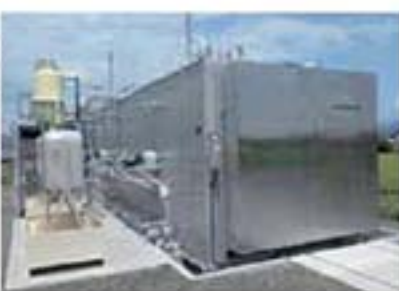
木材を熱処理するプラント(釜)
